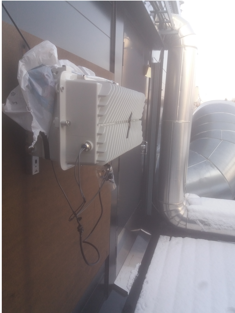
Kuva 12: ICON testiympäristössään katolla ulkoseinässä.
