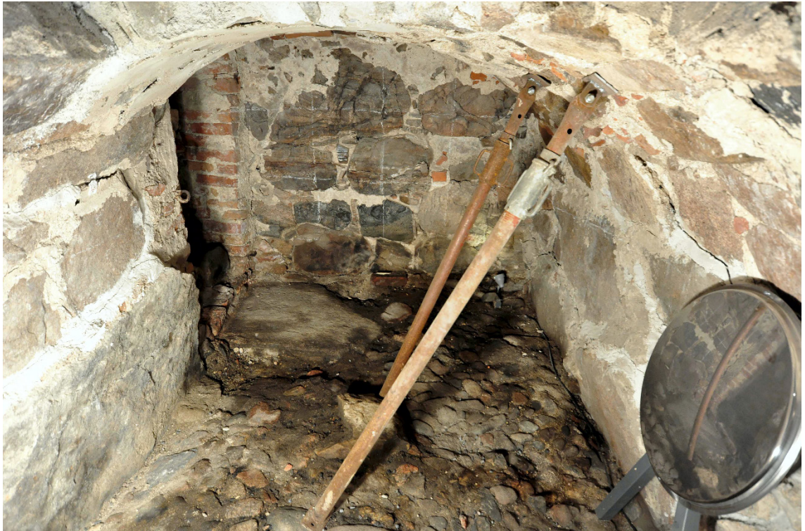
Kuva 22. Kellarin K95:21 tynnyriholvi on tehty kokonaan rakennuskivestä ja tuettu murtumien vuoksi. Kuva: Markus Kivistö.
