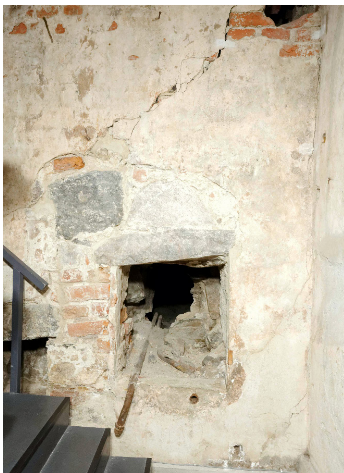
Kuva 16. Kellarin K93:4 koilliskulma. Kapea putkikäytävä johtaa pohjoispuolen pieneen kellariin K94:6 (ei tutkittu). Kuva: Markus Kivistö.
