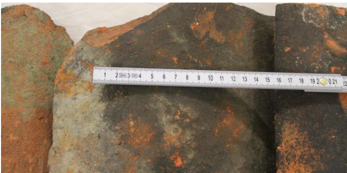
Kuva 52. Etenemä vaakasuunnassa noin 20 cm/tiili. Kuva: Jusa Peltoniemi 2022.
